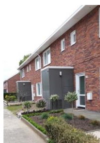
Warmtepompen bij buiten
