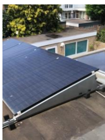
PV-panelen op platte daken
